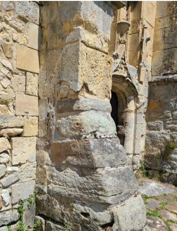
Altération prononcée des pierres des contreforts.
