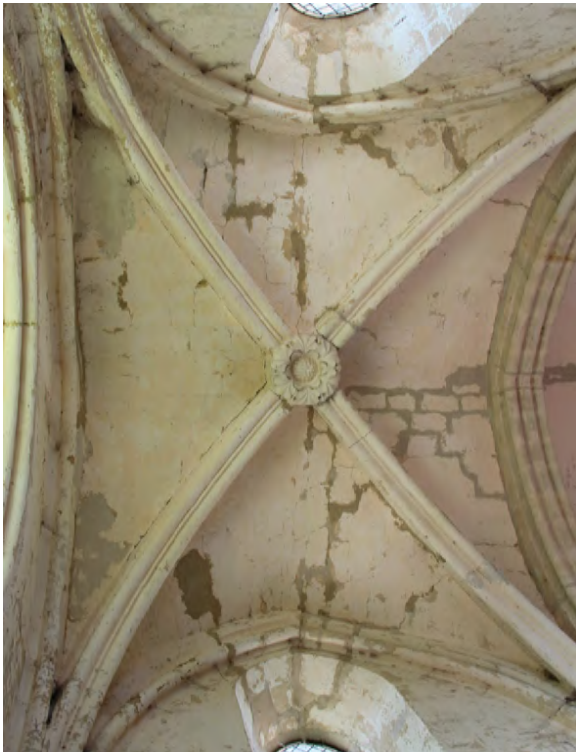
Fissures colmatées au niveau des voûtes du transept.
