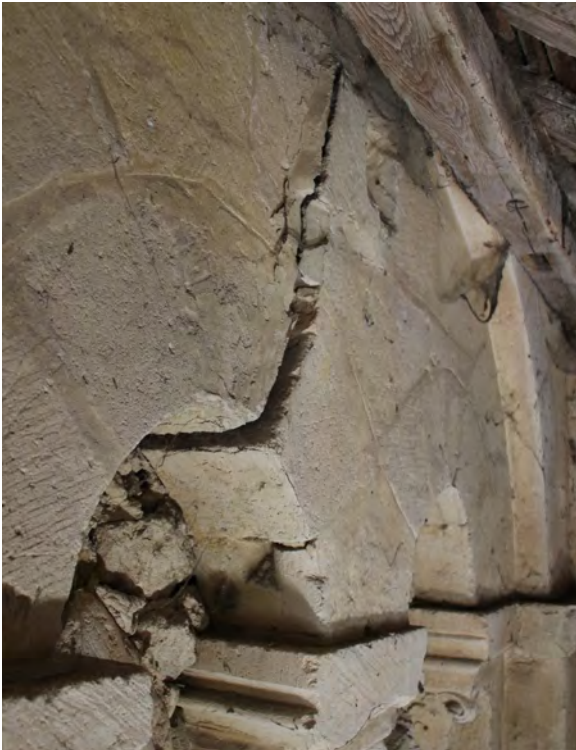
Fissure traversante au droit des voussures de l'arc.
