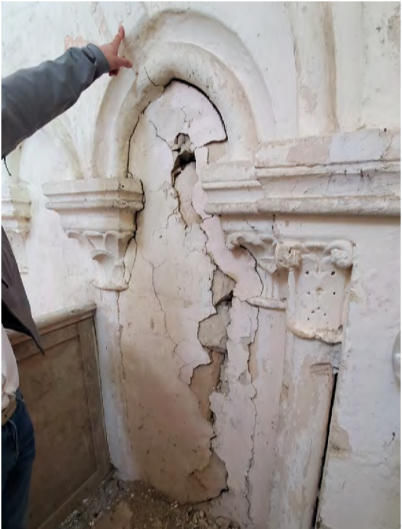
Forte désorganisation et déplacement des maçonneries de bouchement.
