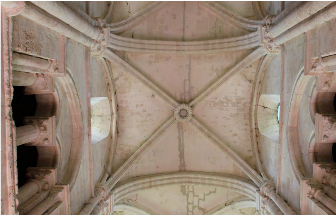
Fissures colmatées au niveau des voûtes de la nef.
