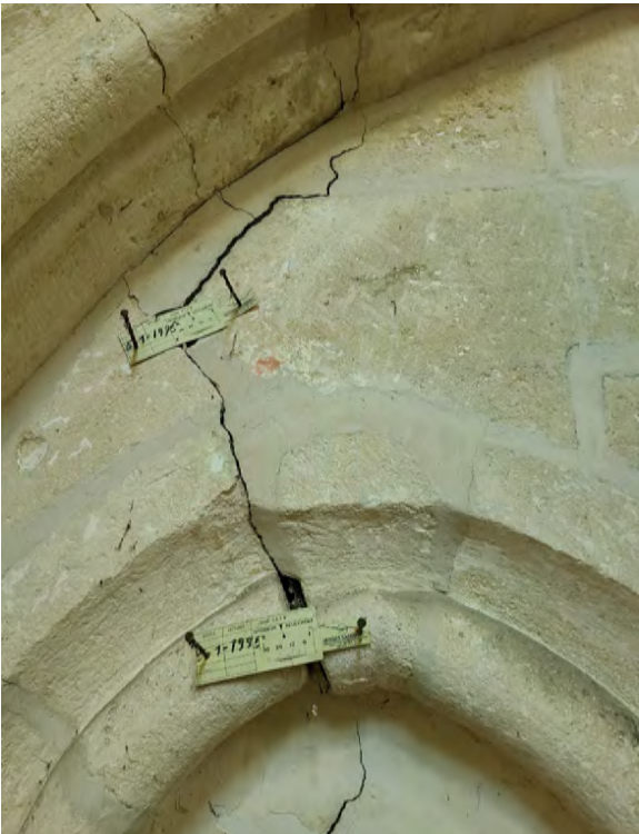
Fissure avec témoins d'ancienne instrumentation.
