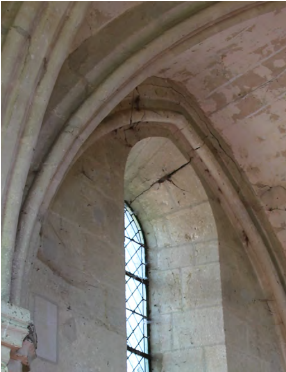
Fissure traversante sur arrière voussure de l'arc de la baie.
