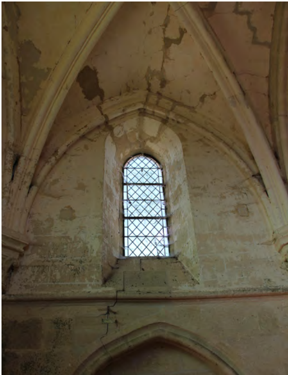
Fissures colmatées au niveau des voûtes et partie haute de la baie. Fissures ouverte au niveau de l'appui de baie.
